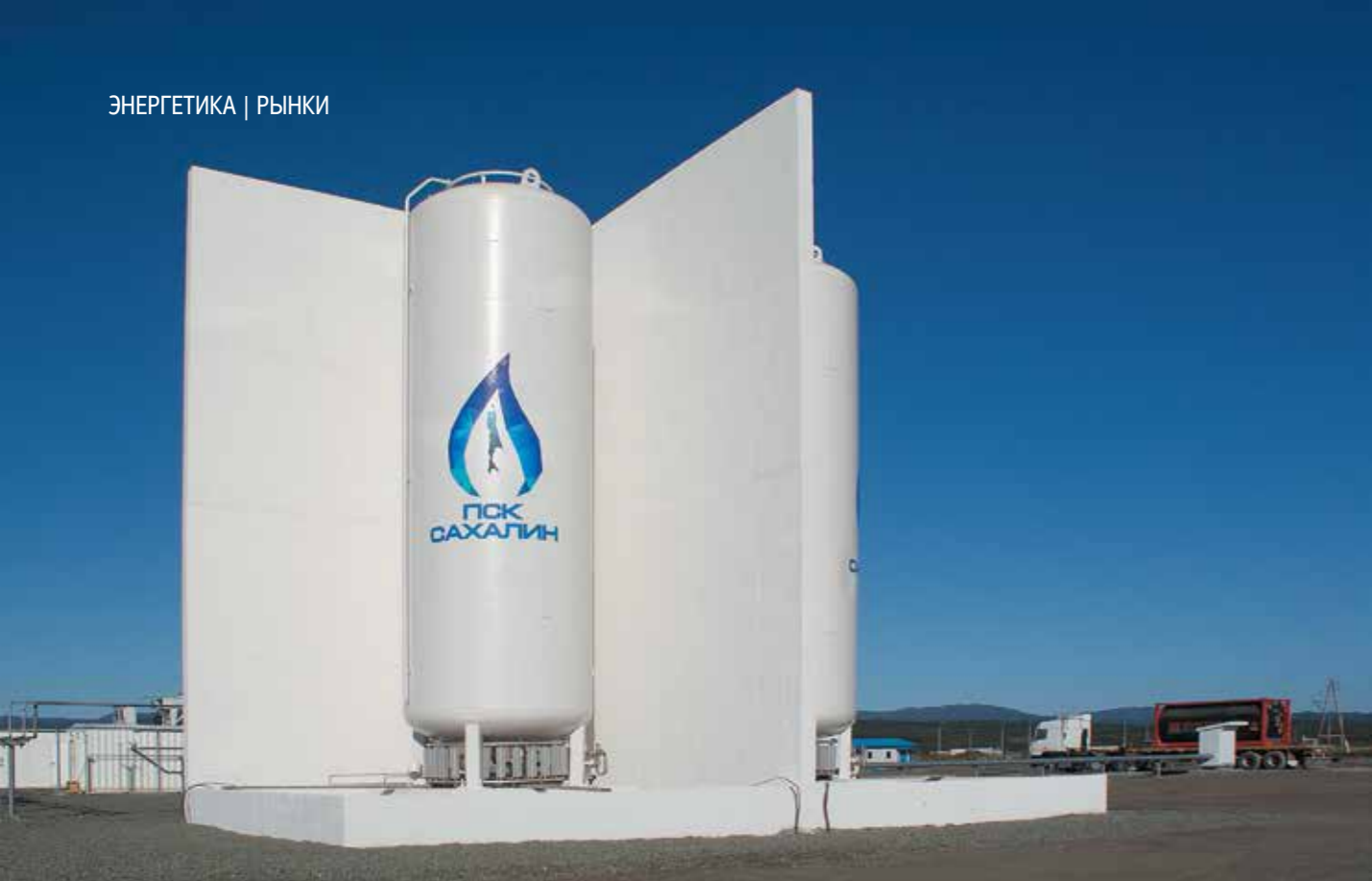
Малотонажный завод СПГ на Сахалине
